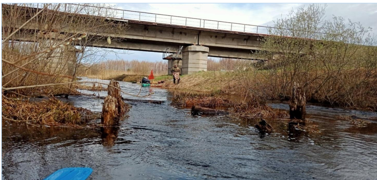
Фото 10. Ж.д.мост. Ниже моста есть старые деревянные сваи, к которым прижимает плавень, перегородившая реку. Проход у левого берега.
